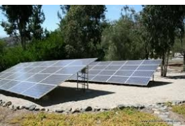
Centrales au sol
